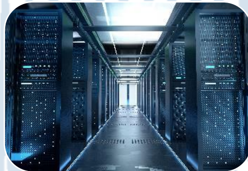
Datacentre, AI & HPC
